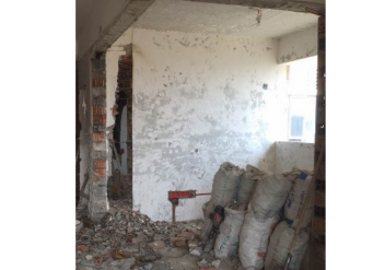
建筑垃圾、废渣集中堆在楼板上 (✗)
