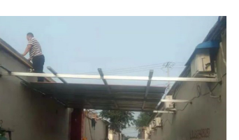
利用房屋墙体擅自搭设 (✗)
