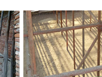
立杆接长未采用对接夹板接头 (✗)
