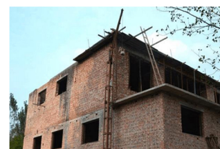
未设置圈梁、构造柱 (✗)
