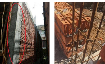
构造柱未留马牙槎 (✗)
