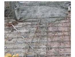
现浇板钢筋被踩踏 (✗)
